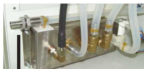
Válvula de vaciado del refrigerante
